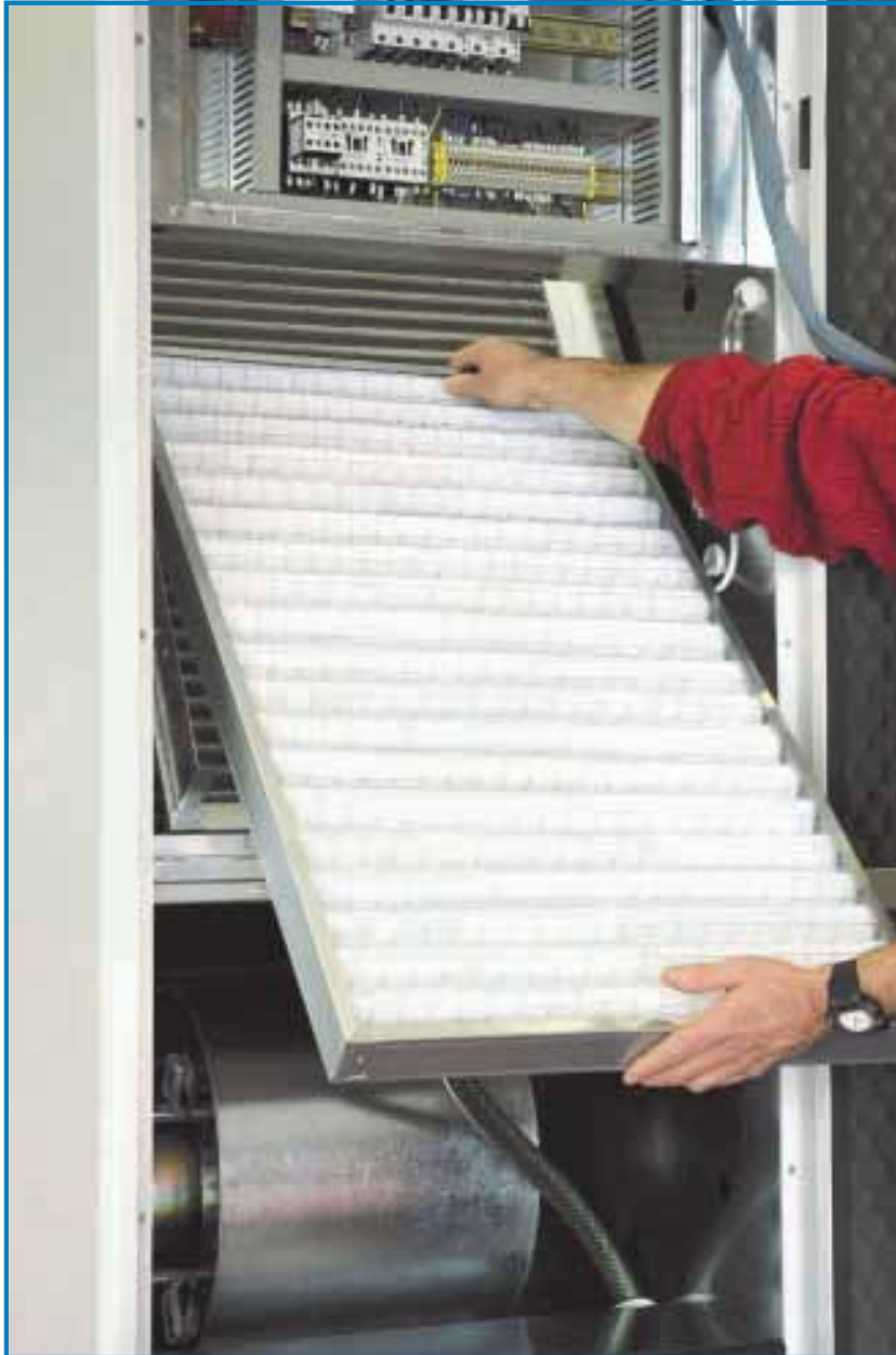
Dettaglio estrazione filtro dell'aria
