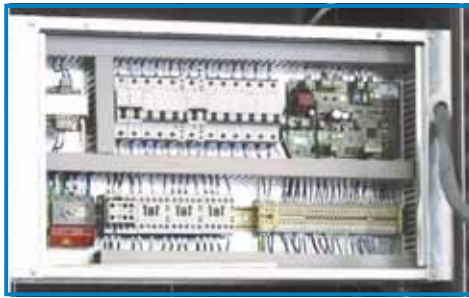
Quadro elettrico modulare Modular electrical cabinet
